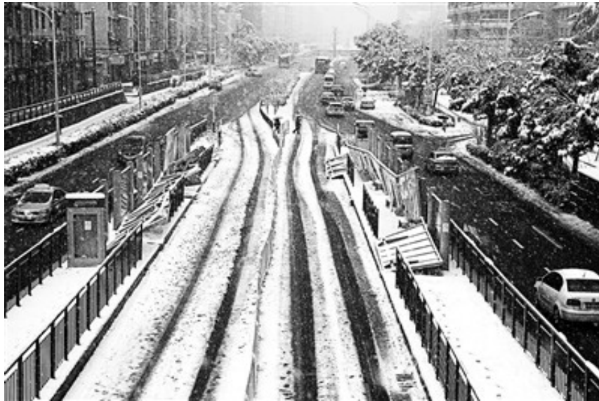
大雪中，合肥市望江路陆续有16处BRT公交站台顶板倒塌供图/视觉中国
